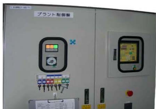
写真 3 バイオガス製造装置制御盤
