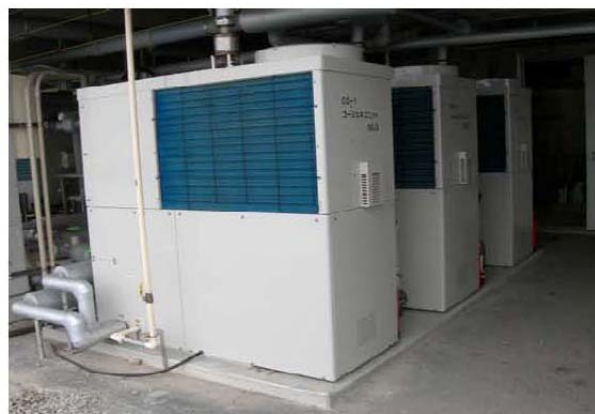
写真7 「道の駅 たるみず」に設置されたバイオガスを燃料にしたコージェネ装置。「道の駅 たるみず」に電力と熱を供給している。
