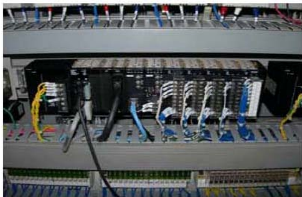
写真 4 バイオガス製造装置制御盤内のオムロン製 PLC。DCS 機能を搭載した CJ1G-CPU43P とプロセス用 I/O ユニットが使われている
