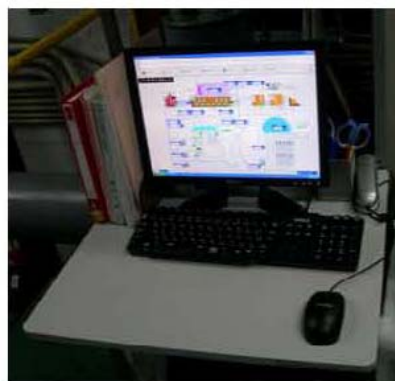
写真 2 監視用パソコン
