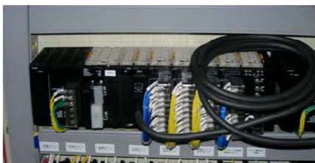
写真 5 バイオガス精製装置制御盤内のオムロン製 PLC
