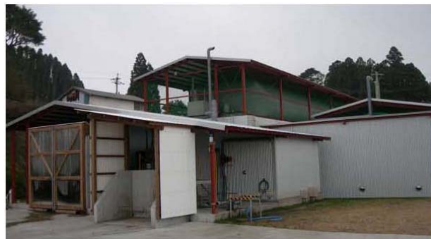
写真1 大隅養豚生産組合の敷地内にあるバイオガス発生プラント
