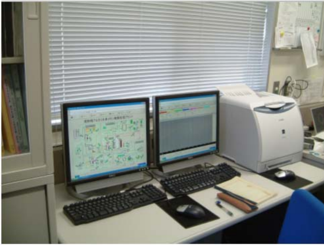
写真2 制御室のHMI2台(1台は予備機として使用)
