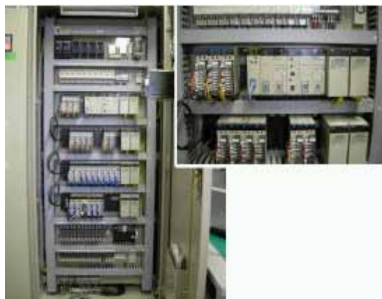
写真 3 制御盤内部とオムロン製の二重化 PLC
