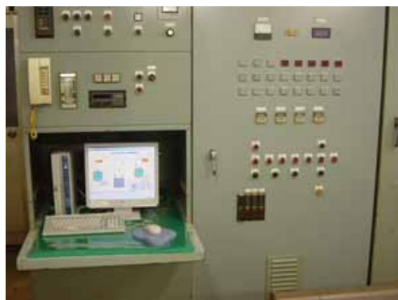
写真 3 盤内のオペレーション・コンソール
