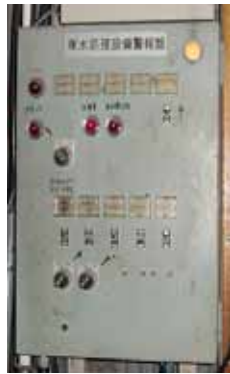
<従来設備> 排水処理見張り室
