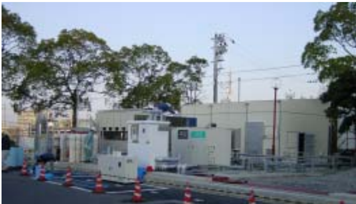
写真1 水素供給ステーション全景
