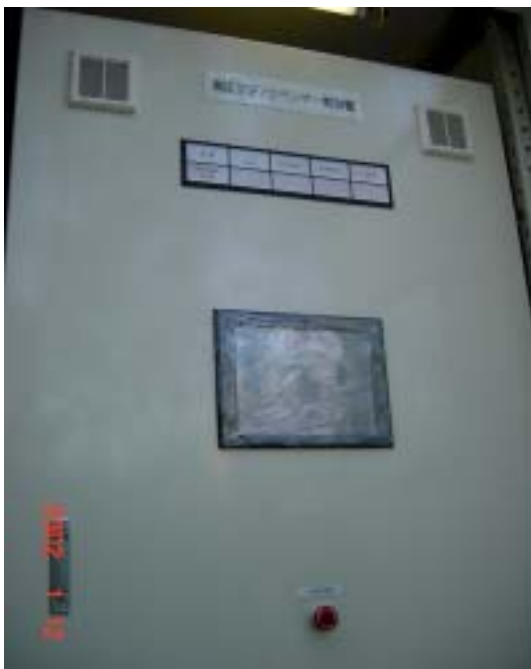
写真2 高圧型ディスペンサー用制御盤パネル面
