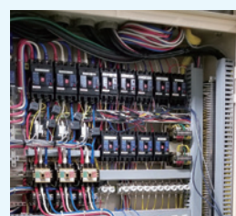
制御盤内機器の異常発熱
